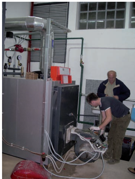
Slika 2: Srednja škola Duga Resa – Instalacija novog niskotemperaturnog kotla
