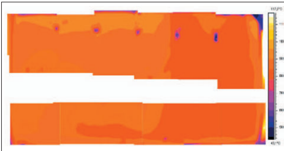
Slika 3.T termogrami s temperaturnom raspodjelom na plohi vanjskog plašta
